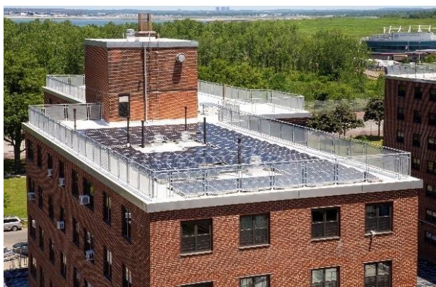
Reparación del techo y sistema de paneles solares en Ocean Bay (Bayside)
